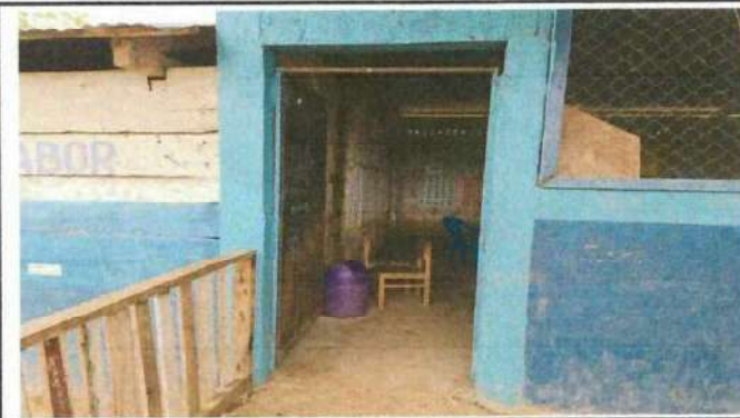
Foto 4: PUERTAS EN MAL ESTADO EN LAS AULAS
