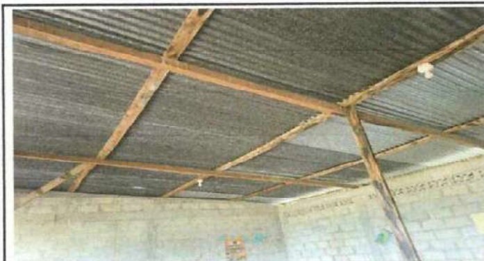
Foto 3: ESTRUCTURA DE MADERA A PUNTO DE CAER EN LAS AULAS
