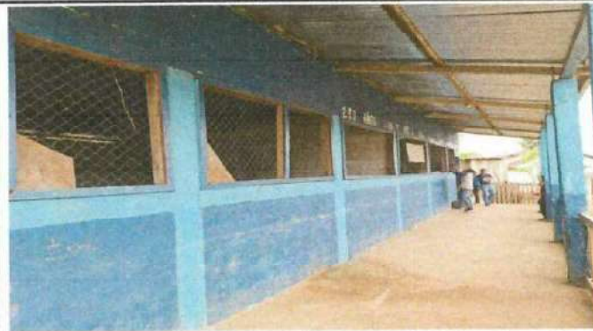
Foto 2: ESTRUCTURA Y CUBIERTA DE LAMINA EN MAL ESTADO
