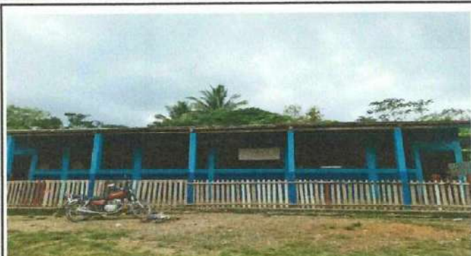
Foto 1: PARTE FRONTAL DE LA CUBIERTA DE LAMINA EN MAL ESTADO
